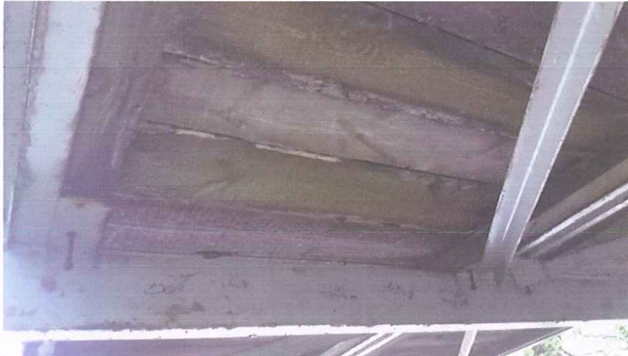
Fot. Nr 3 Korozja biologiczna podkładu górnego i konstrukcji kładki- widok od spodu
