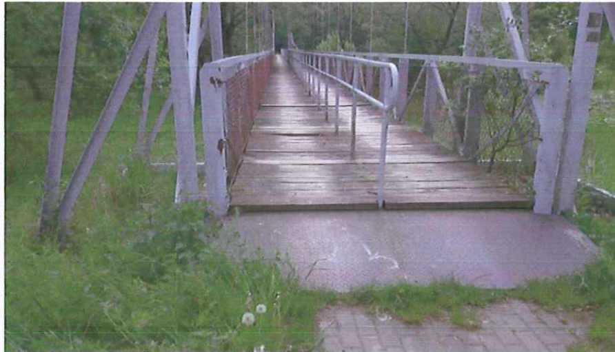
Fot. Nr 5 Korozja elementów stalowych w tym blachy ryflowanej przy wejściu na kładkę od strony ul. Bieckiej
