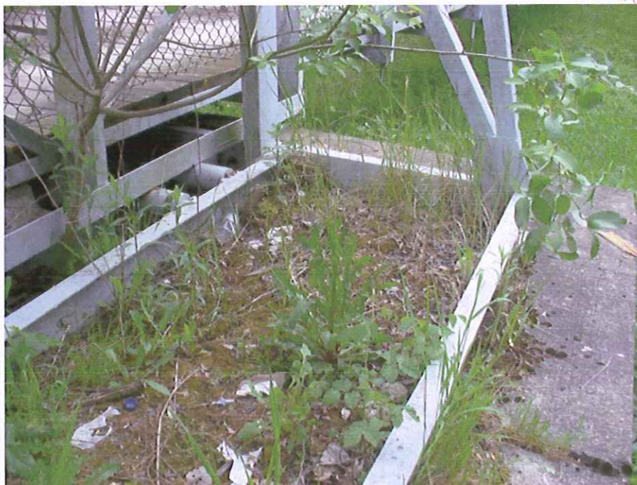
Fot. Nr 9 Stan fundamentu pylonu i rowku odwadniającego oraz korozja łożyska stałego.
