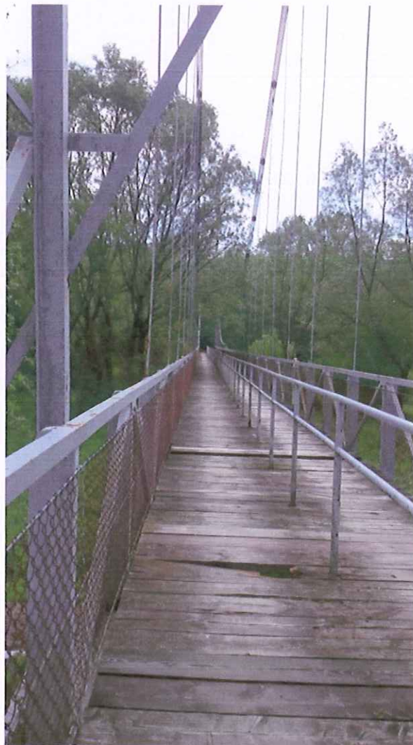
Fot. Nr 2 Zniszczony podkład górny kładki stalowej wiszącej na rzece Ropie.
