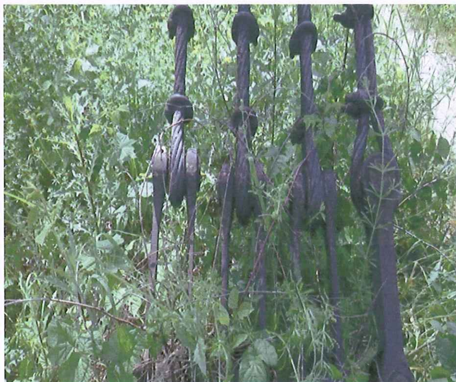
Fot. Nr 10 Zakotwienie urządzeń naciagowych lin stalowych kładki pokryte roślinnością i przykryte ziemią.
