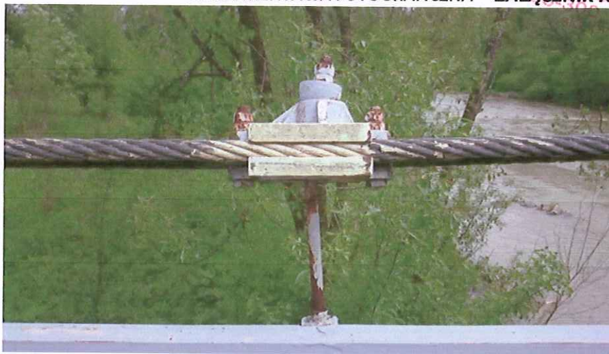
Fot. Nr 13 Skorodowane ciągnie wraz z zamocowaniem.
