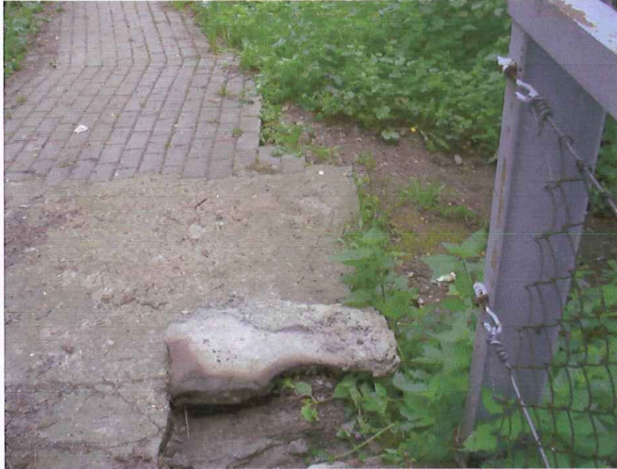
Fot. Nr 7 Widok zniszczonego chodnika przy wejściu na kładkę od strony lasu
