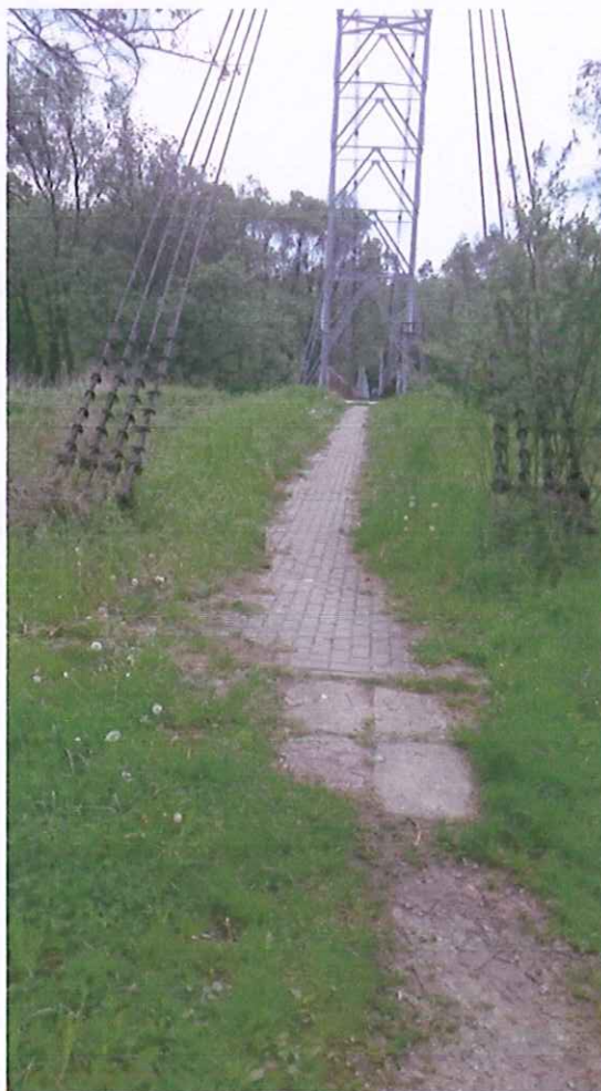
Fot. Nr 6 Chodnik z kostki brukowej od ul. Bieckiej w stronę kładki -porośnięty roślinnością i miejscowo zapadnięty .
