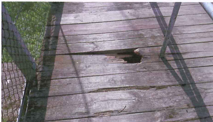
Fot. Nr 4 Stan zbutwiałych desek podkładu górnego i skorodowanej siatki zabezpieczającej balustrady kładki stalowej wiszącej
