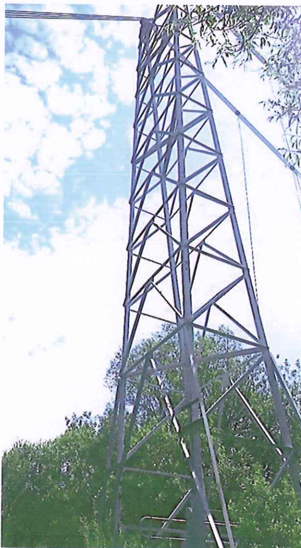
Fot. Nr 14 Korozja elementów stalowych pylonu kratowego kładki stalowej .
