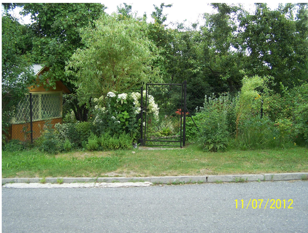
10) Działka nr 2276 – demontaż istniejącej furtki oraz pręseł poprzedzających. Wykonanie słupków bramki na wysokość +75cm, odbudowa murka ogrodzeniowego w skosie od +30 do +75cm. Odtworzenie ogrodzenia na nowych rzędnych wysokościowych. Budowa 4 stopniowych schodów terenowych (ZL-15a)
